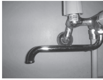
原因となった水道
