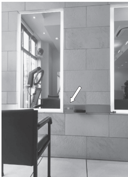
図3 美容室の壁に設置されたコンセント（矢印、床から高さ70cm程度）
