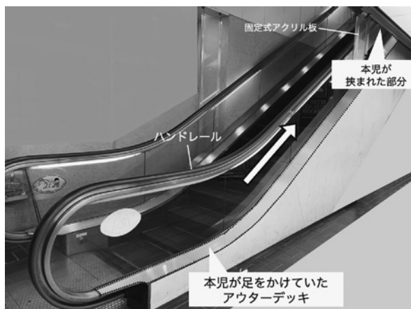
図1 エスカレーター外側のアウトターデッキ（点線で囲った部分）から矢印方向へ昇っていった
